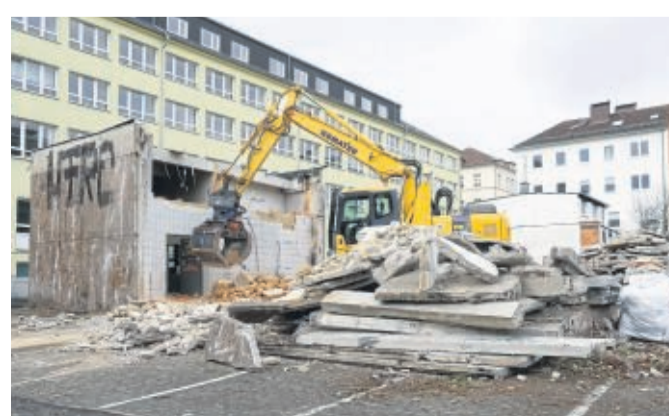
War einsturzgefährdet: Das Garagen-Gebäude an der Friedrichsstraße wird abgerissen.
